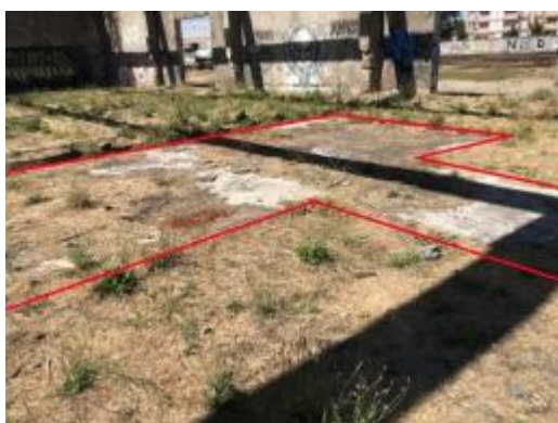
Fig.60. En esta imagen se puede apreciar un vestigio de radier ubicado en el cuerpo 1 del edificio, como se grafica en los planos de levantamiento.
