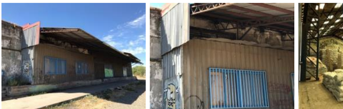
Fig.55. En la imagen de la izquierda se aprecia las características morfológicas y de materialidad discordantes e invasivas para el edificio original, del Galpón metálico adosado al cuerpo 4. La imagen del centro, es un detalle de la fachada que da cuenta de la precariedad de la construcción metálica y la imagen de derecha muestra una vista del interior en la cual se aprecia los sacos de fertilizantes.
