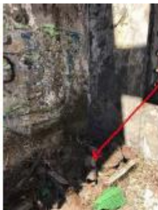
Vestigio de una del par de duchas existente en Camarines de hombres
