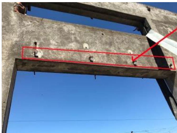
Fig. 63. En esta imagen se puede observar los vestigios de los soportes metálicos del riel de los portones corredizos, empotrados al dintel de los vanos.
