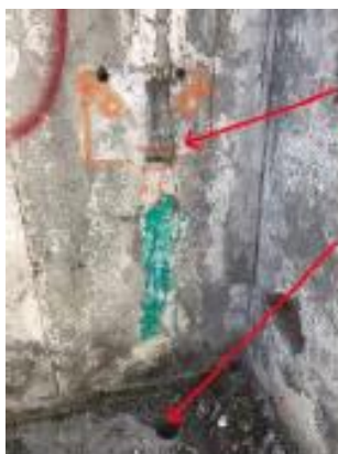
Se detecta vestigio de desagüe de WC y estanque elevado de baños de mujeres
