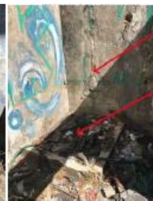
Vestigio de pie de ducha hecho en obra y vestigios de las cañerías de agua para ducha en baños de mujeres
