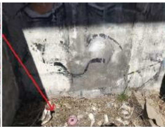
Se detecta vestigio de desagüe de WC en recinto de baño de hombres de hombres
