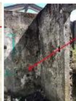
Vestigios de instalaciones de lavabo baño de mujeres
