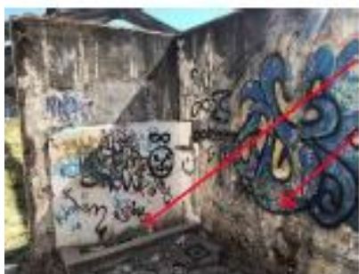
Uninario hecho en obras casi integro en Camarines de Hombres.
